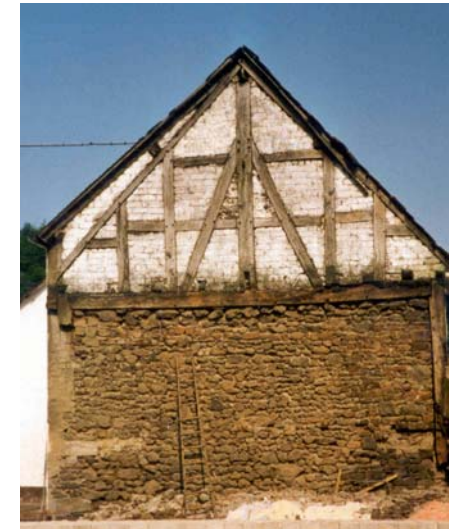
Abb. 3: Blick auf den Westgiebel mit massivem Bruchsteinmauerwerk und Fachwerkgiebel. Die vorgeblendete Fassade ist auf der linken Seite im Schnitt erkennbar nachträglich vorge-mauert und das straßenseitige Dach gehoben, das gesamte Giebeldreieck wurde neu ausgemauert (Aufnahme 1985)
