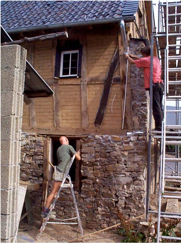
Abb. 14: Holz, Lehm und Naturstein als hauptsächlich verwendete Baumaterialien – August 2003
